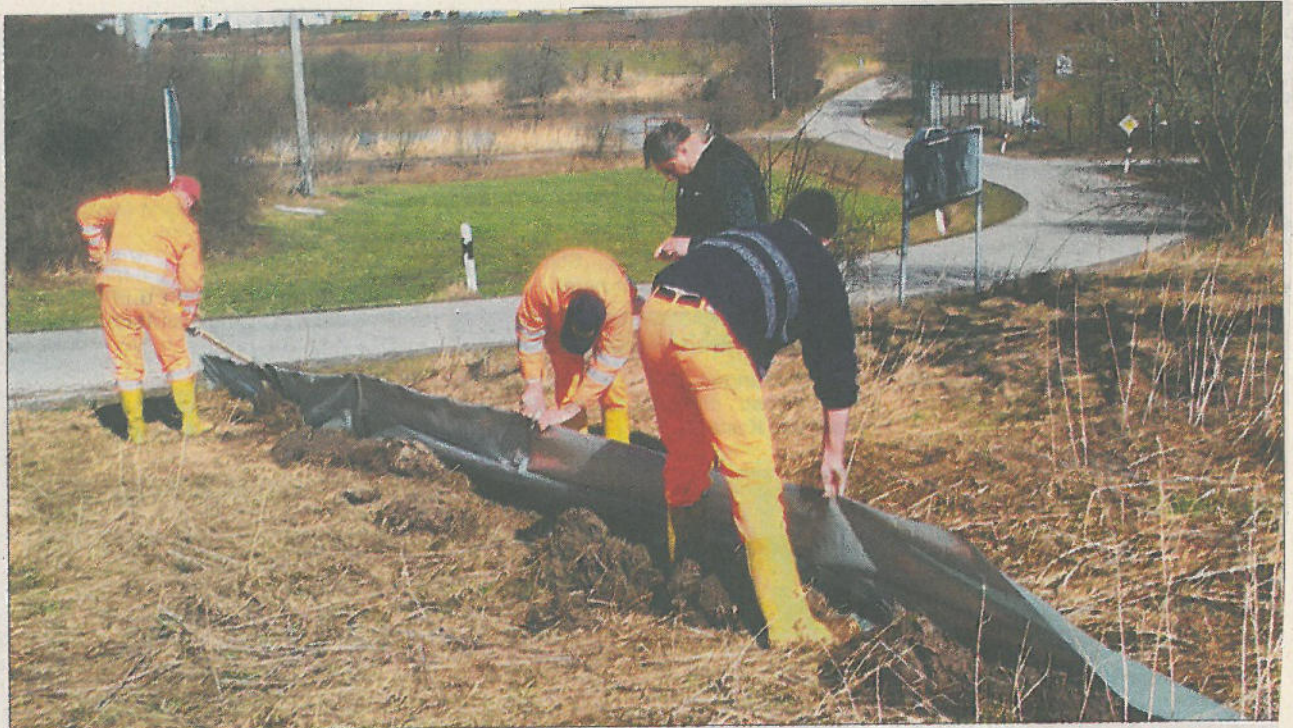
Die Arbeiter des städtischen Bauhofes legen kürzlich im Bereich der Trasse zur geplanten Süd-West-Tangente einen Amphibien-Zaun an, damit die Wanderung der Tiere dokumentiert werden kann. Foto: Herrmann
