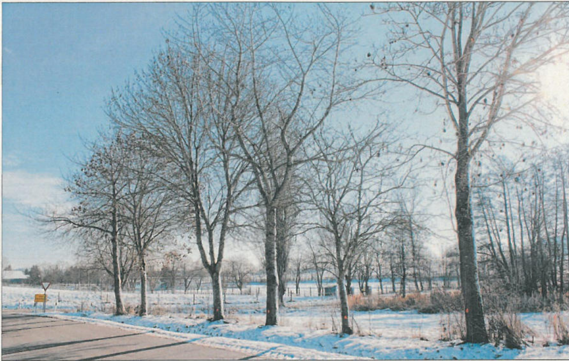
Umfangreiche Rodungsmaßnahmen mit der Fällung von Bäumen – wie hier an Mosbacher Weg/Esbacher Weg und Heckenweiher – müssen für die Freilegung des Baufelds bis Ende Februar ausgeführt werden. Foto: Herbert Dinkel
